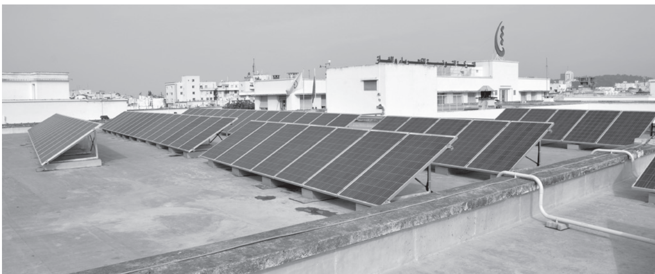
Vue des panneaux photovoltaïques installés au siège administratif de la STEG
